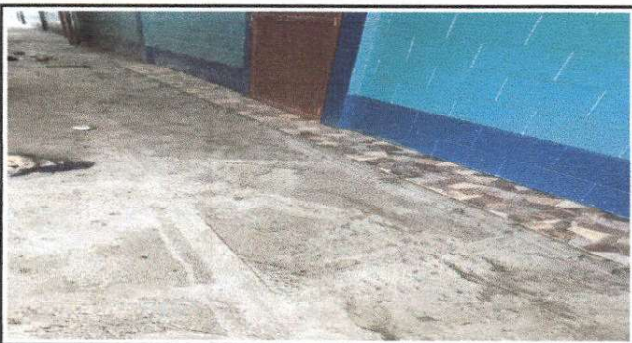
Foto11: Sustrucción por piso Cerámico Corredor
