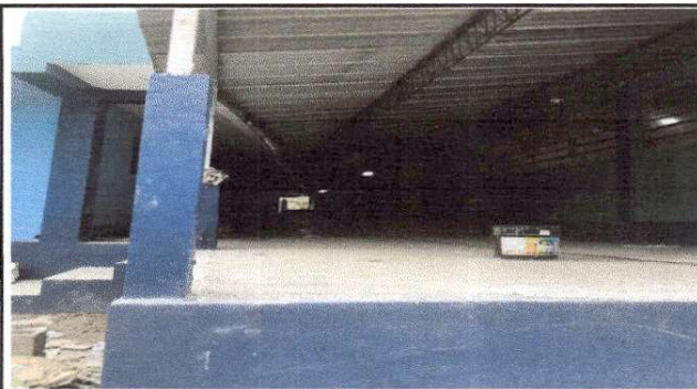
Foto 10: Sustrucción por piso Cerámico Corredor
